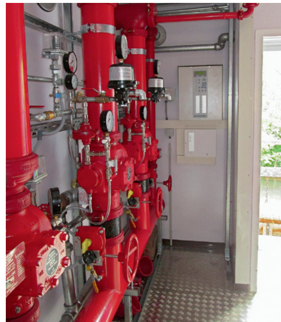
Die Anlage wurde gemäß der Richtlinie TRVB S 122 EAL (Erweiterte Automatische Löschiilfe) geplant
